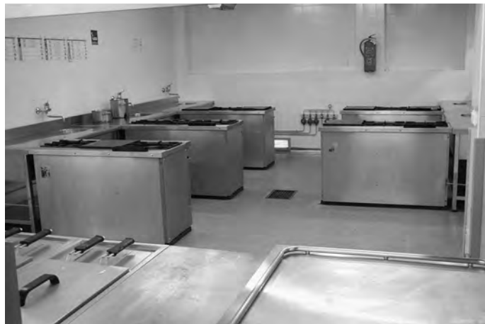
Figura 12.24. Instalaciones de cocción fraccionadas.
