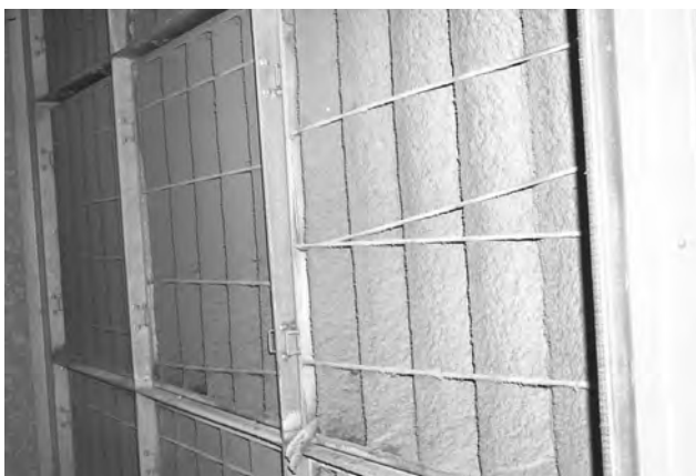
Figura 8.5. Filtros situados en la entrada de aire.
