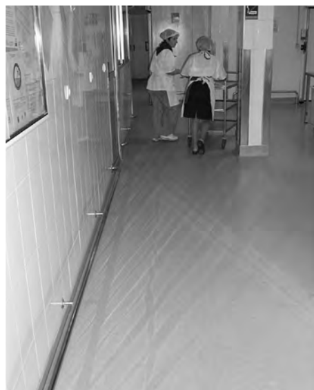
Figura 7.5. Detalle de barra de protección en pasillo de paso de carros.
