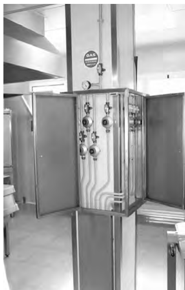
Figura 7.31. Protección de grifería de gas.
