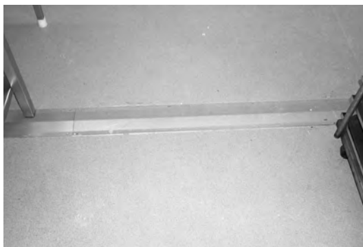
Figura 7.32. Protección de regata para canalización en el suelo de conductos de gas.
