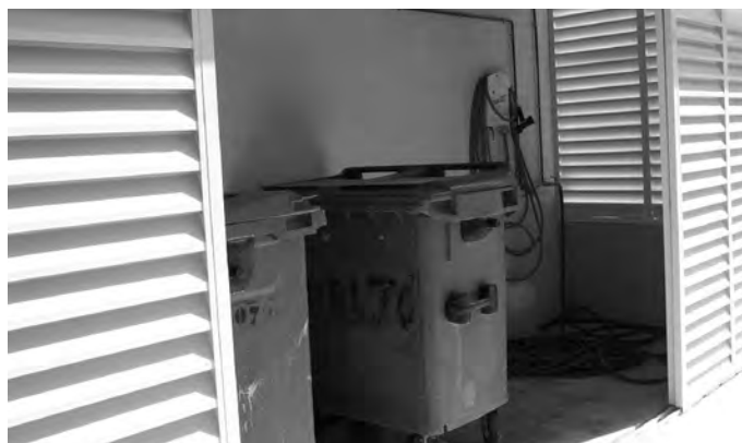
Figura 6.49. Cuarto de basuras.
