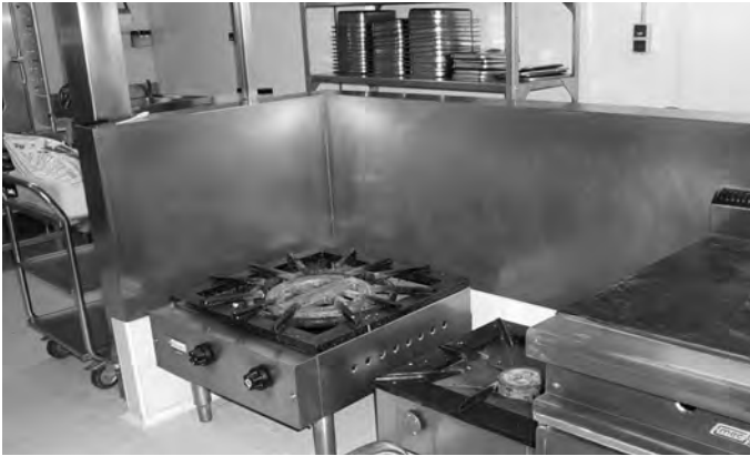
Figura 7.6. Protección tras instalaciones de cocción murales.
