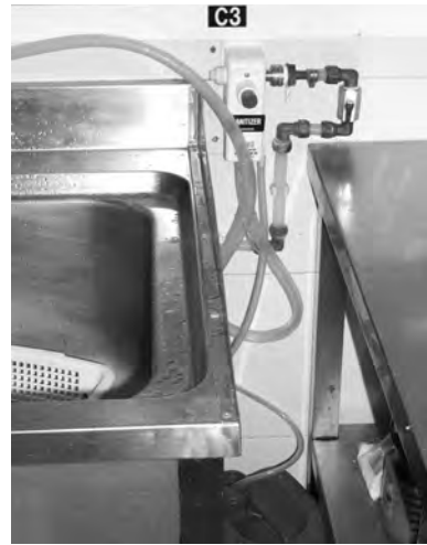
Figura 14.17. Dosificador automático de lejía.
