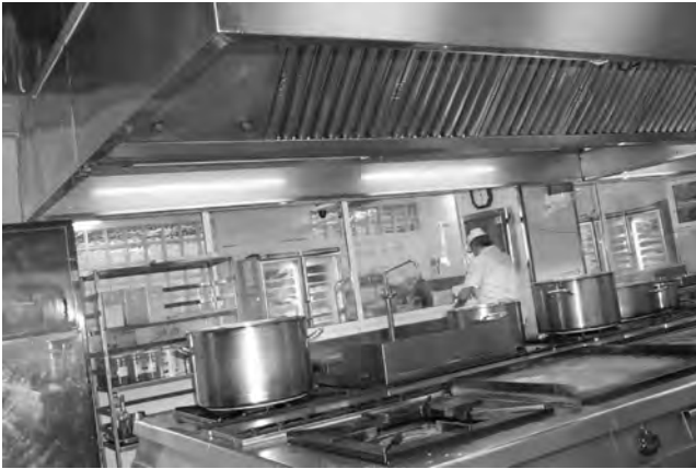
Figura 8.3. Ventilación localizada por campana de extracción forzada.
