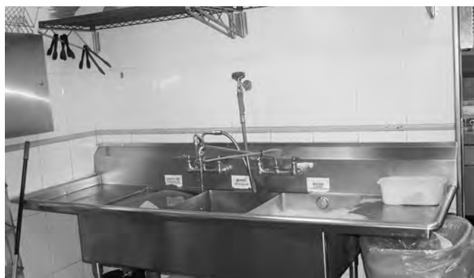
Figura 16.14. Plonge con tercer fregadero para desinfección química.
