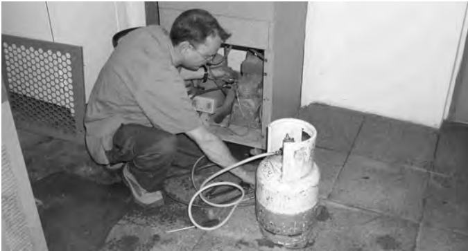
Figura 17.7. Carga de fluido frigorígeno.
