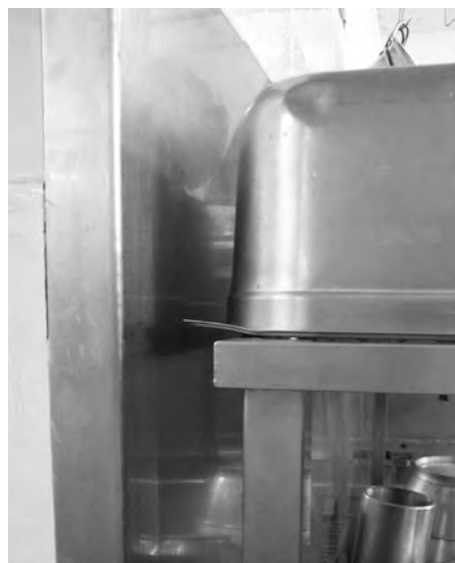
Figura 7.4. Protección de pared en zona de plonge.
