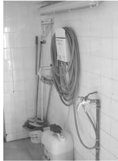
Figura 6.50. Dotación para la limpieza de contenedores.
