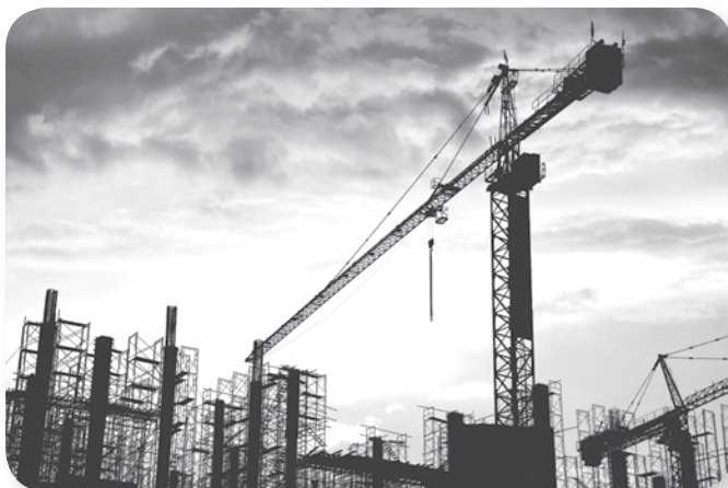
Figura 2.7 Las obras de infraestructura son fundamentales en la administración de los proyectos como el Foro Universal.
