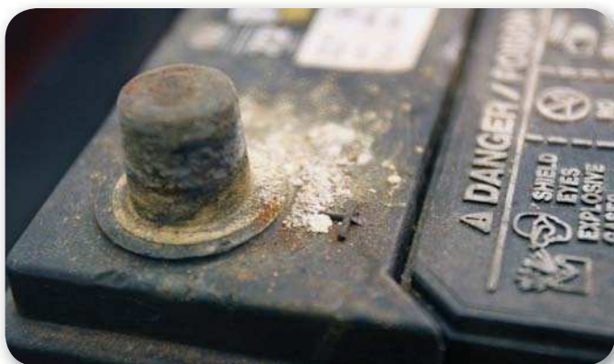
Figura 9. Este tipo de bornes se sulfata muy rápido y puede llegar a dañar el conector si no los limpiamos o revisamos regularmente.
