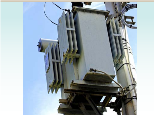
14.19 El transformador se emplea para elevar o reducir el voltaje.
