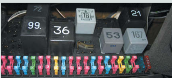
↑ Figura 7.31. Caja eléctrica de relés y fusibles.
